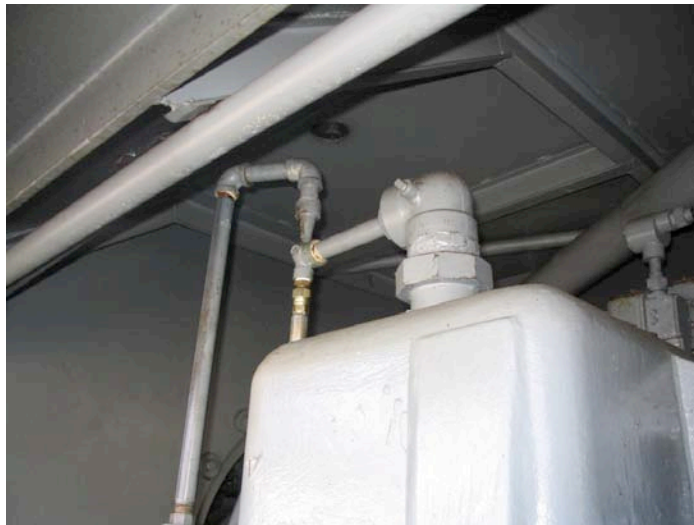
Fig. 1: Venturi atop gear box
